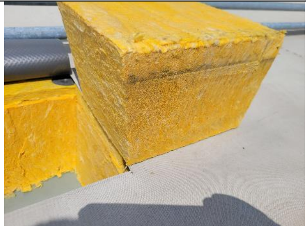
Isolering smutsig ut mot takfoten
