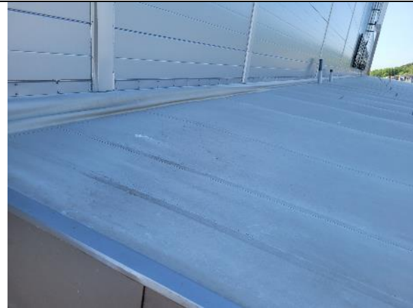
Takduken har släppt i anslutning mot gavel
