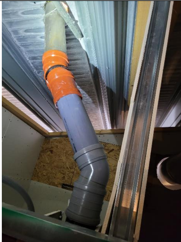
Samma avloppsluftare sett från insidan, rör knäckt och man ser dagsljuset innanför
