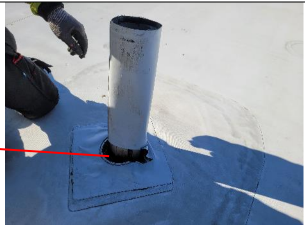
Mycket stora skador runt avloppsluftare
