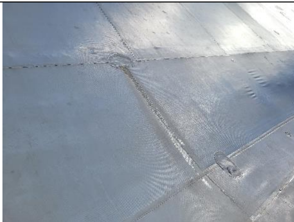
Flera lappar har gjorts med dräneringskanal i botten
