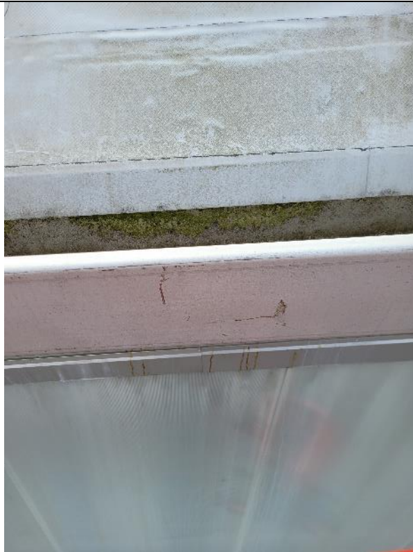
Uppströms ovanför missfärgningarna på väggen kan vatten noteras rinna denna dag. Taket inspekteras inte högre upp pga säkerheten
