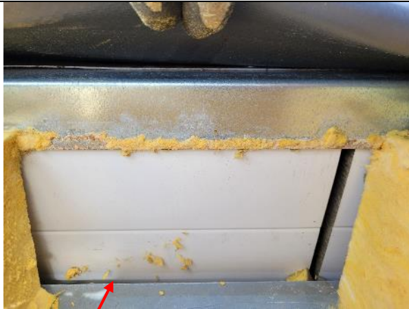
Stora lufttättheter mellan tak- och väggkonstruktion
