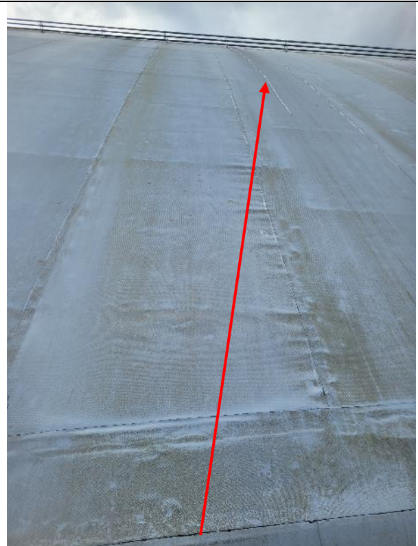
Uppströms ovanför missfärgningarna på väggen kan vatten noteras rinna denna dag
