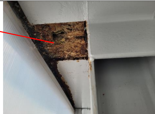
Längs med yttervägg i passage plan 3 noteras rikligt med missfärgningar och rostangrepp
