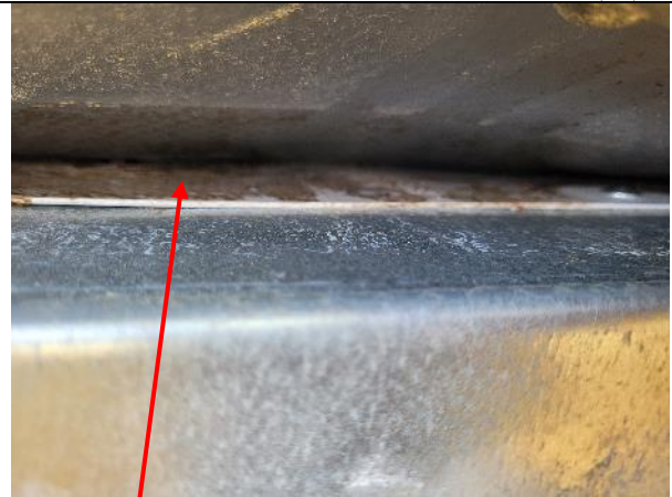
Missfärgningar mellan takduk under fotplåt och övre takduk
