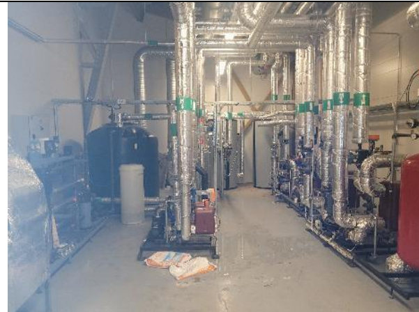
Orsaken till fuktskadorna på tak och väggar i damernas wc plan 2 är läckande ventil i fläktrum plan 3
