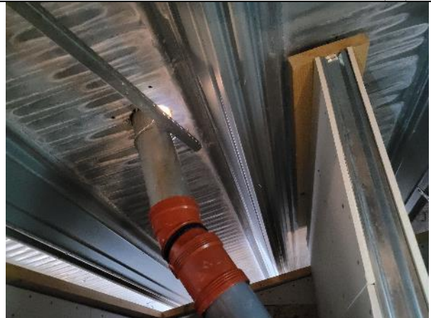
Samma avloppsluftare sett från insidan, rör knäckt och man ser dagsljuset innanför
