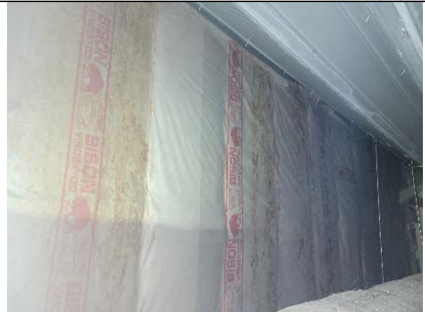
Vägg mot ishall ovan undertak i pressläktare. Rikligt med missfärgningar på vindduken
