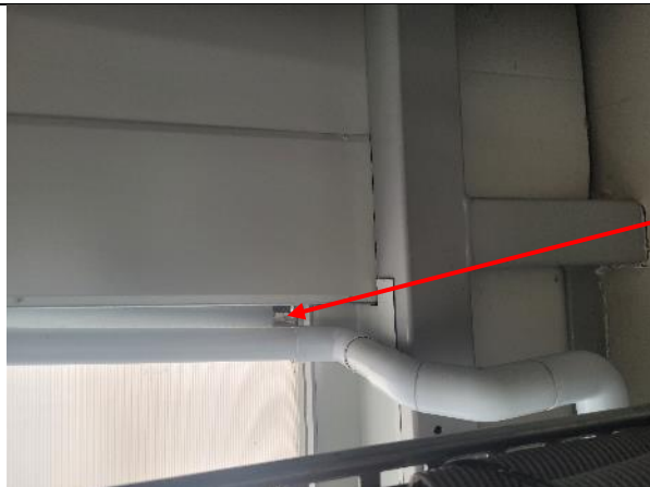
Stora lufttättheter finns i yttervägg/fasad
