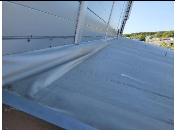
Takduken har släppt i anslutning mot gavel
