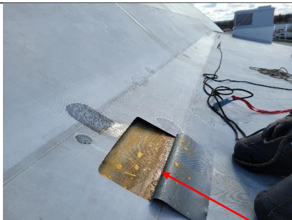
Provhål nr 2, i knäcken mellan taken. Vatten mellan dukarna
