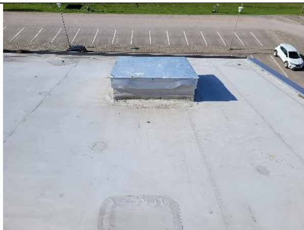
Igensatt huv eller rökgaslucka skadad
