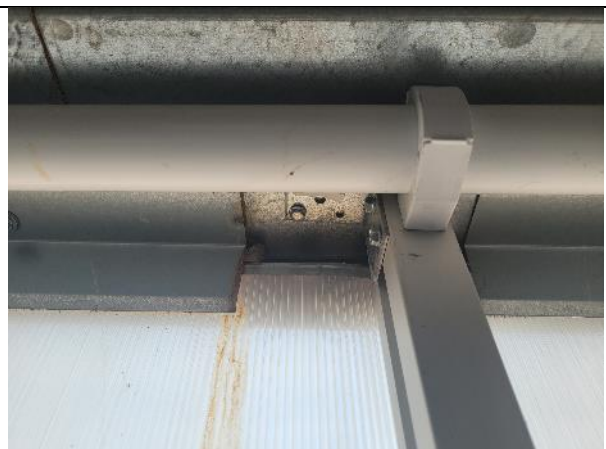
Rikligt med rinnmärken längs med ytterväggen
