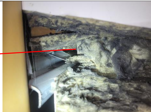
Vid anslutning mellan yttervägg och yttertak kan man konstatera stora lufttättheter
