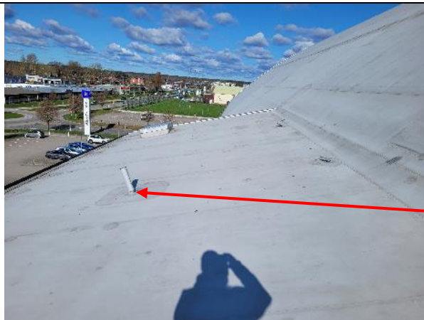
Mycket stora skador runt avloppsluftare
