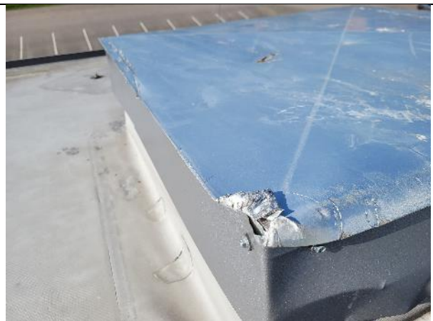
Igensatt huv eller rökgaslucka skadad
