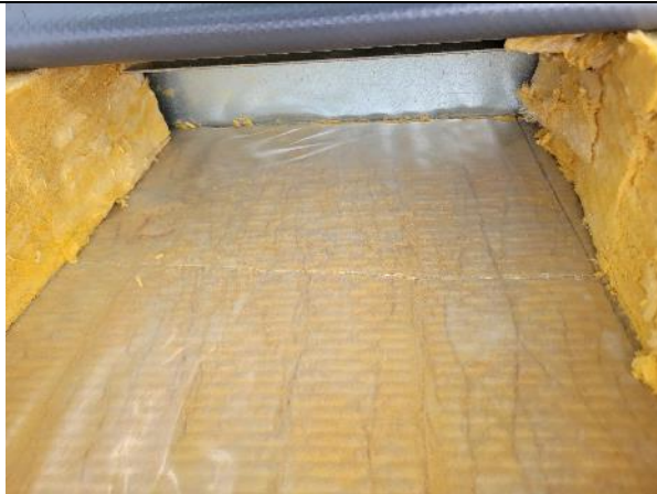
Inga uppenbara missfärgningar på plastfolien här
