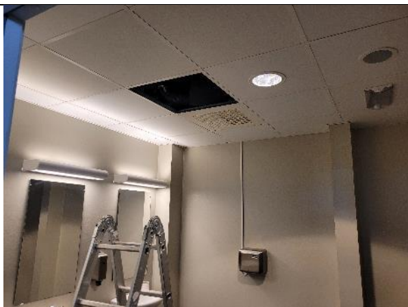
Fuktskador tak damernas wc
