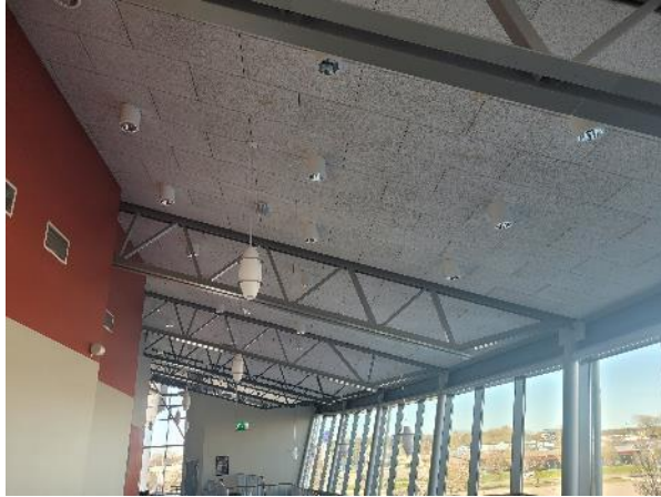
Missfärgningar på undertaksplattor noteras på flera ställen
