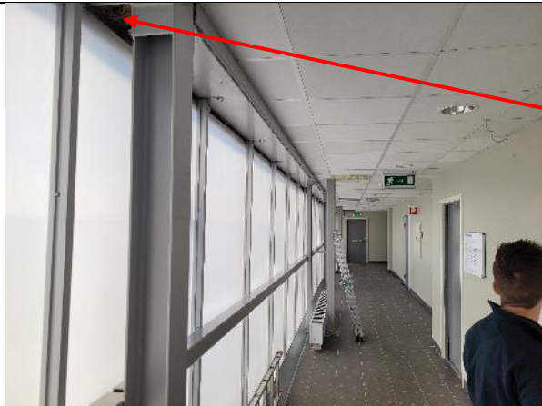
Längs med yttervägg i passage plan 3 noteras rikligt med missfärgningar och rostangrepp
