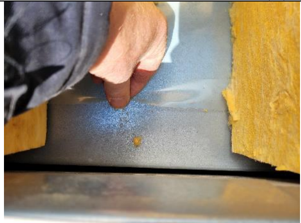
Plastfolien slutar en bit från takfoten, ej lufttätt
