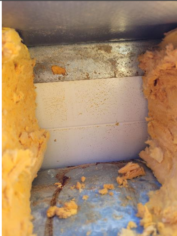
Plastfolien inte tätad/tejpad på väggens sandwichelement
