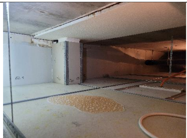
Fuktskador tak damernas wc
