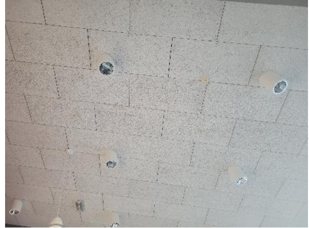
Missfärgningar på undertaksplattor noteras på flera ställen
