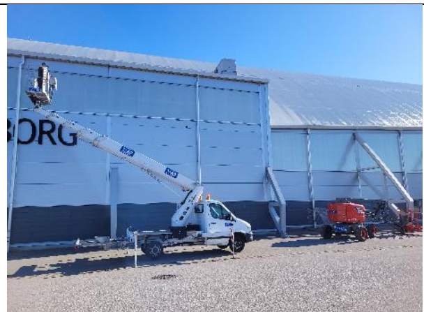
Taket inspekteras (mindre delar) via skylift samt genom att gå ut igenom taklucka
