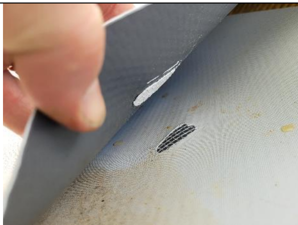
I övergången mellan det stora taket och taket över "VIP-båsen" släpper punktsvetsarna från varandra
