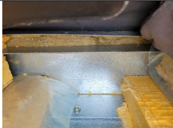
Vy ner mot takfot. Plastfolien är inte tejpad
