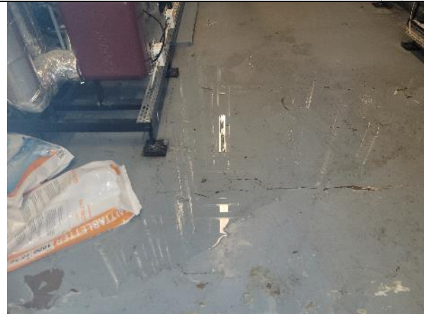
Orsaken till fuktskadorna på tak och väggar i damernas wc plan 2 är läckande ventil i fläktrum plan 3
